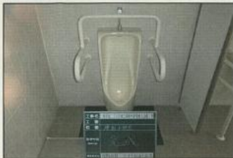
給水設備:屋内 (完成)
