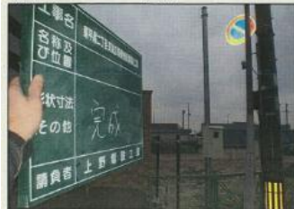
構内外線 (完成)
