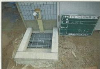
給水設備:屋外 (完成)
