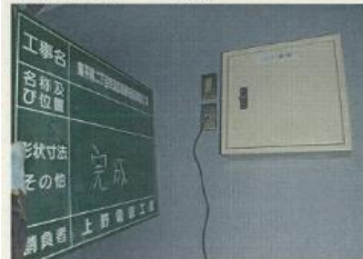
電灯コンセント設備 (完成)
